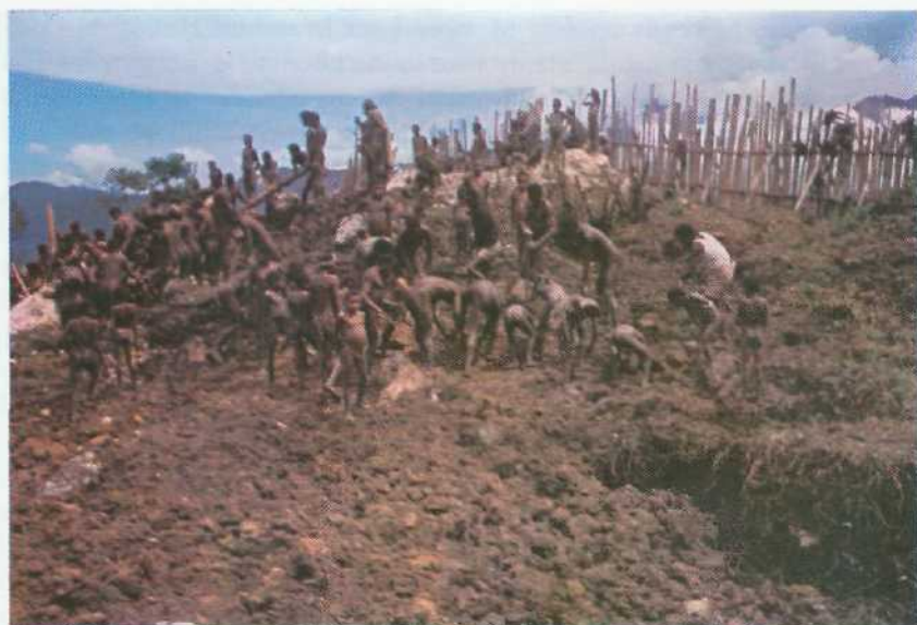
Bij het werk op de strip moet ook het transport van aarde vaak met de hand geschieden; hier wordt een heuvel afgegraven.
